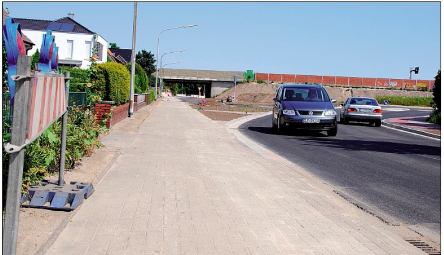
Sperrung aufgehoben: Die Absperrschilde sind an die Seite gestellt. Der Autoverkehr rollt über die neue Fahrbahn der Molberger Straße. Foto: Georg Meyer
