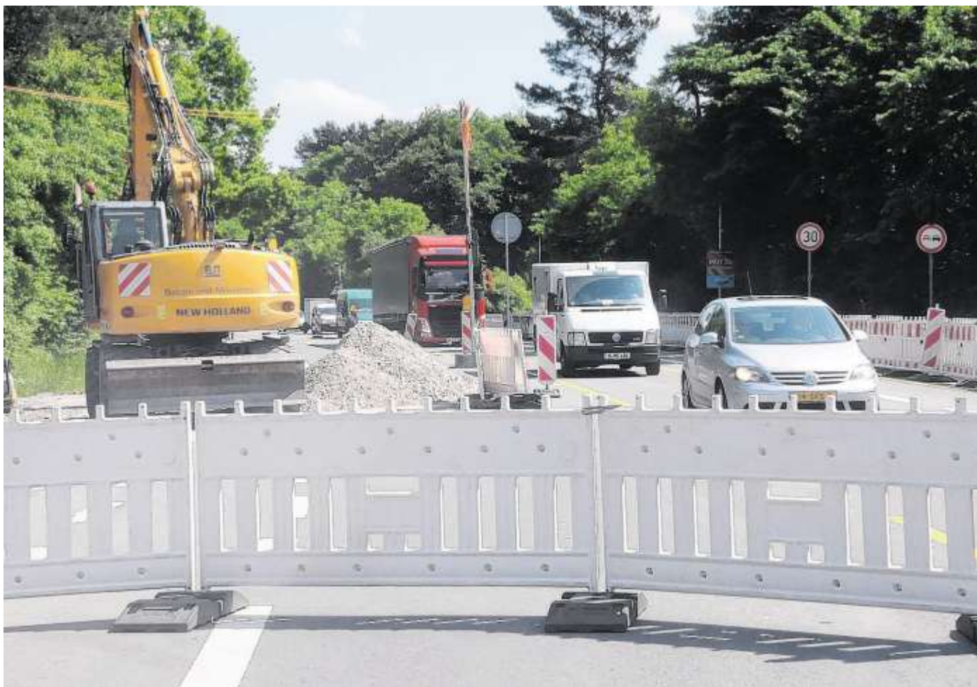
Engpass: Die Baustelle auf der B 68 in Künsebeck in Höhe des Schnatwegs, der künftig als Verbindung zur Entlastungsstraße sowie später als Autobahnzubringer fungiert, wird den Verkehr in den kommenden Wochen beeinträchtigen.
